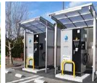
EVバス充電施設の設置
